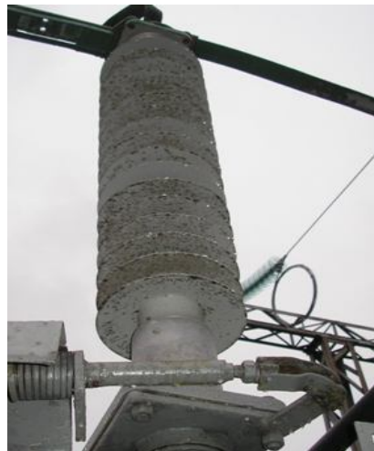
Рисунок 1. Полимерный изолятор с загрязнением
